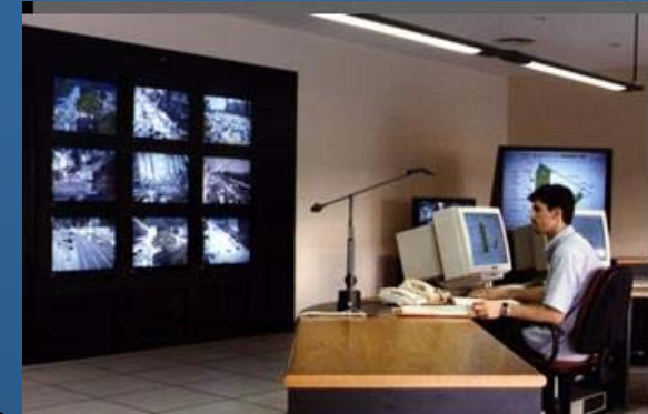
SISTEMA DE CCTV
